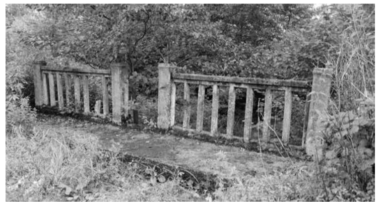
Остатки ограждения старого моста через ручей. К слову, мостом и поныне активно пользуются жители Пушкарёво.
